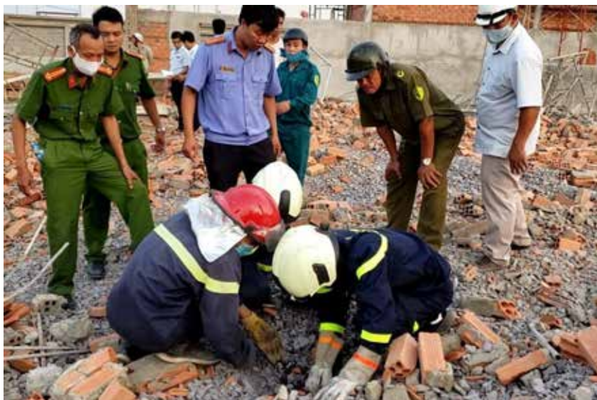
Ngày 14-5-2020, tai nạn lao động tại công trình xây dựng nhà máy Công ty Cổ phần AV Healthcare - Khu công nghiệp Giang Điền, huyện Trảng Bom, tỉnh Đồng Nai làm 10 công nhân chết và 14 công nhân bị thương. Hình báo Dân Trí
